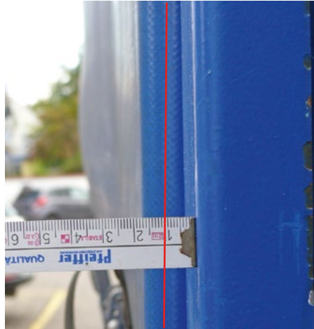
Die Seitenwand darf sich nicht mehr als 1 cm nach außen wölben.
